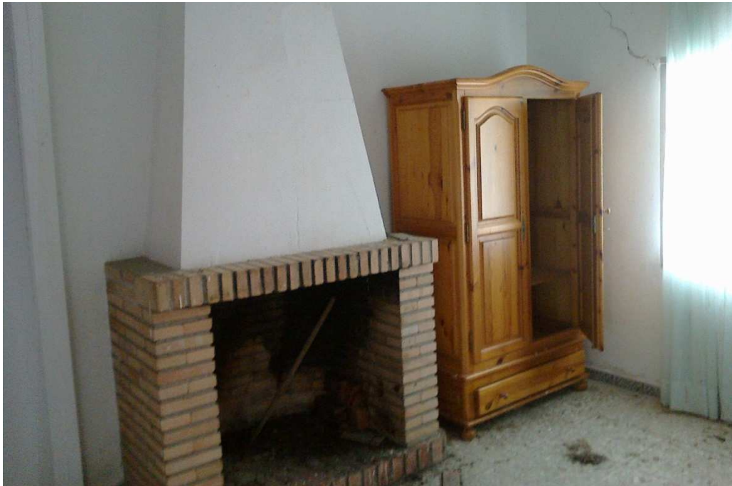
Figura 8. Sala de espera del consultorio médico, con una chimenea francesa que podría conservarse. En el cerramiento se observa una grieta generada por asientos diferenciales en el terreno.
